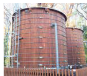
都内療育センターで使用している木製受水槽
