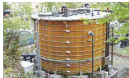
瀬音の湯で使用されている木製受水槽
